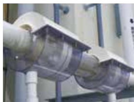
配管繋ぎ手の二重化 排水配管について、繋ぎ手を二重化し、 漏洩防止と漏洩確認が出来るように しています。
