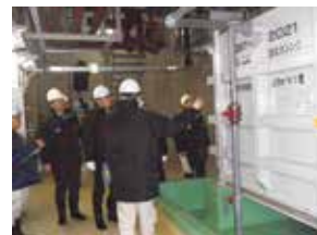
地下中継槽の機能と管理状況の説明を受け、評価を行う監査員
