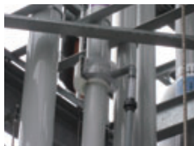
配管継ぎ手二重化 配管継ぎ手を二重化し漏洩防止と液漏れ確認ができるようにしています。
