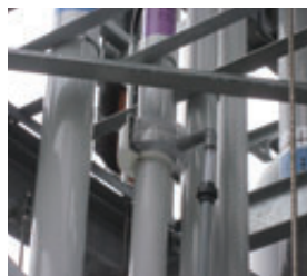
配管継ぎ手二重化 配管継ぎ手を二重化し液漏れを確認できるようにしています。
