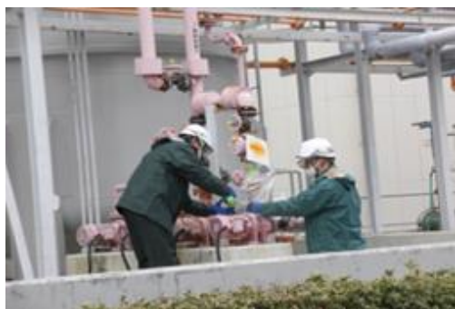
移送ポンプ吐出フランジからの薬品漏洩を想定
